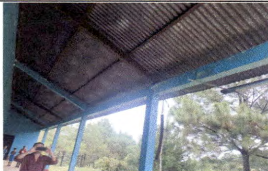
Foto 7: Vigas oxidadas en pasillo.
