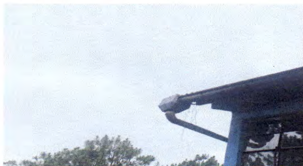
Foto 5: Canal y bajadas de agua en mal estado.
