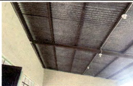
Foto 2: Vigas oxidadas en interior de módulo 1.
