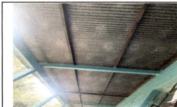
Foto 3: Láminas oxidadas en pasillo.
