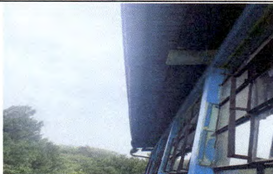
Foto 9: Vigas quebradas del módulo 1.
