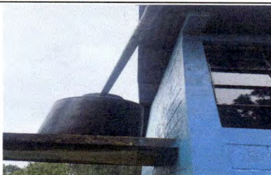
Foto 10: Tanque de agua sin bajadas adecuadas.
