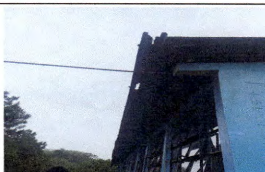
Foto 4: Láminas quebradas y con hoyos.
