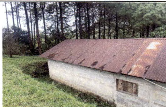
Foto 8: Láminas en mal estado por corrosión.
